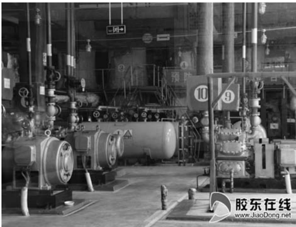
图22 氨制冷用压力容器压力管道
