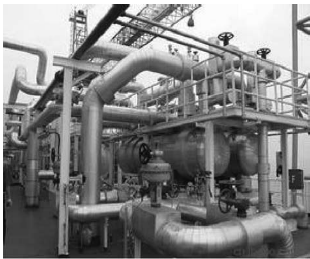
图9 工业压力管道
