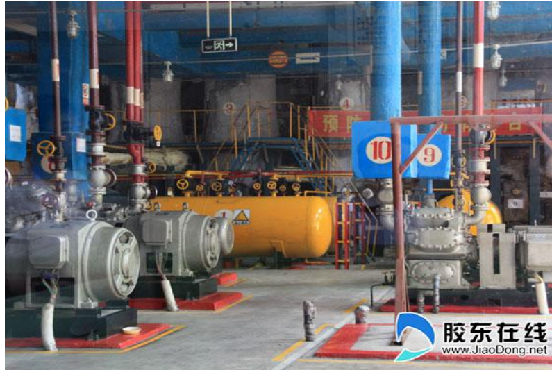
图 22：氨制冷用压力容器压力管道
