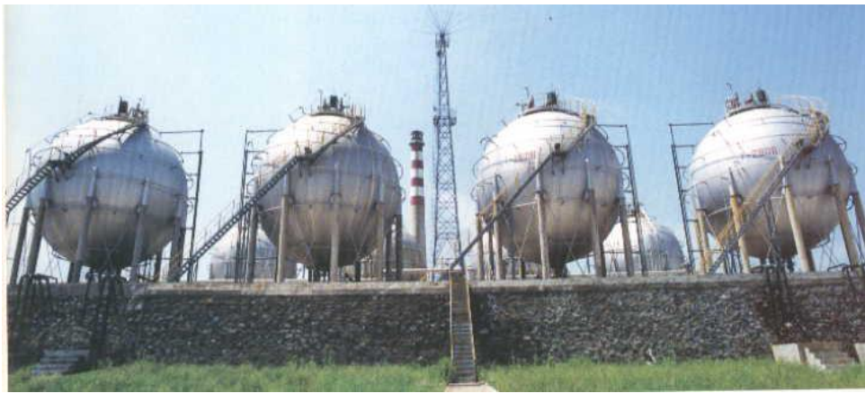
图 6：固定式压力容器（球形储罐）
