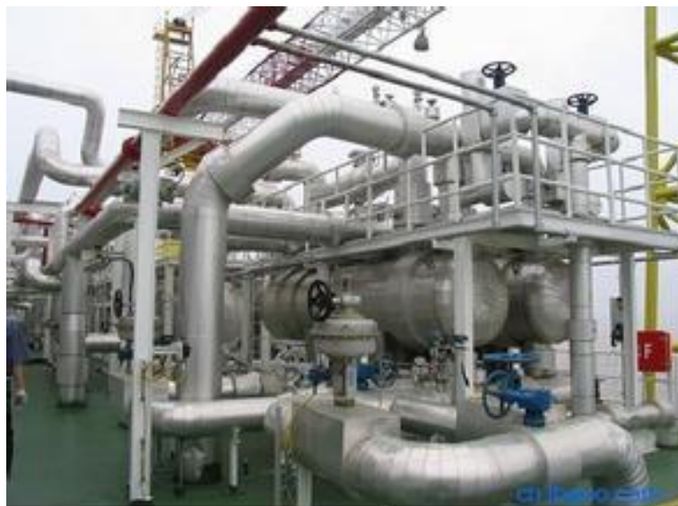
图 9：工业压力管道
