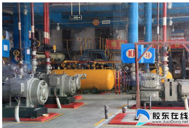
图 21：氨制冷用压力容器压力管道
